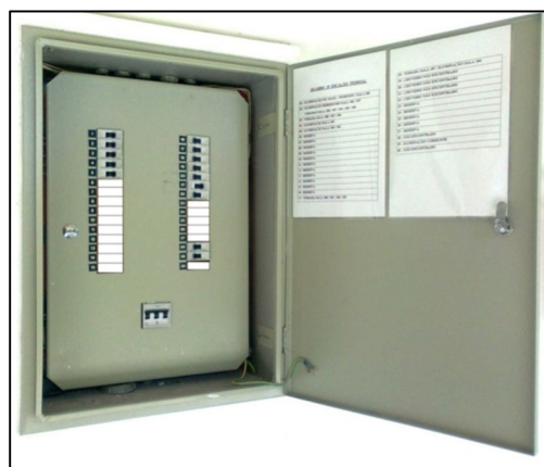
Identificação dos disjuntores no quadro
