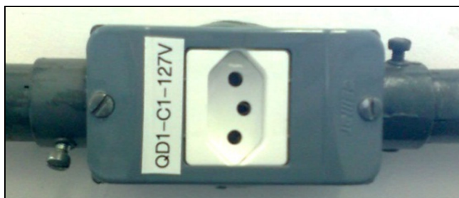
Identificação tomada elétrica
